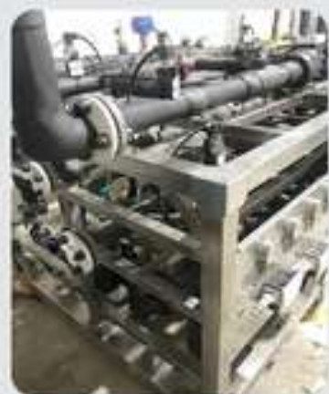
Насосная станция рекуперации теплоты
